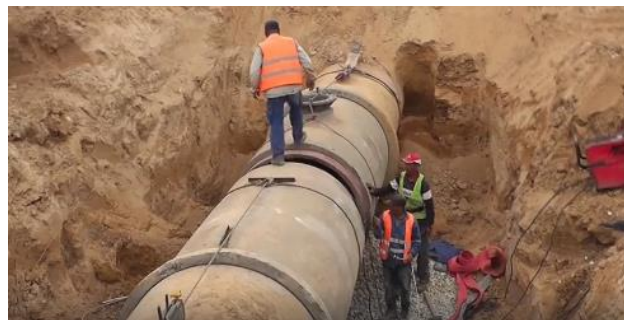
Réparation de la casse de la conduite DN 1600 vers Sfax le 26 juin 2018 (zones touchées : Gouvernorats de Mahdia et Sfax)
