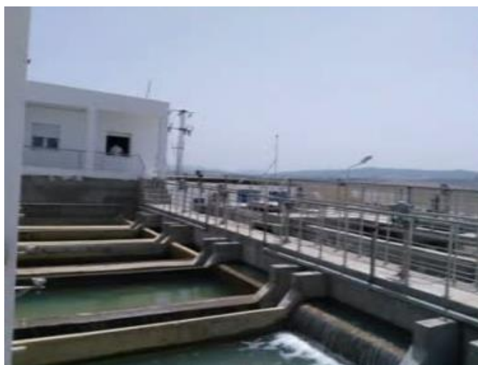
Station de traitement Sejnane
