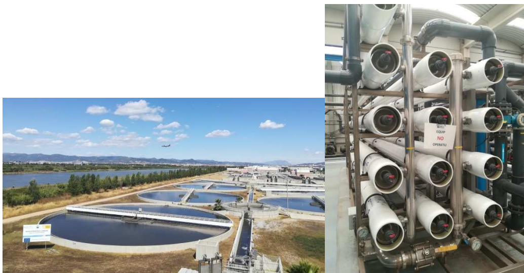
Figure 14 : STEP El Prat de Llobregat (osmose inverse à droite) – Ecofilae© Declercq
