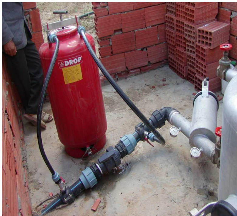
photo 5 : installation comprenant un injecteur d'engrais
