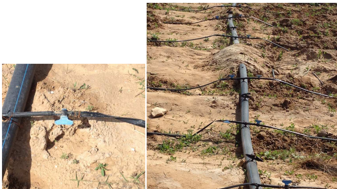
Photo 3 : vannettes installées au départ des goutteurs. Ce système devient rapidement ingérable.
